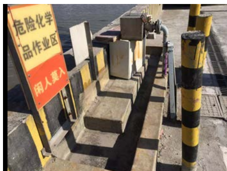
硫酸密闭输送管道
